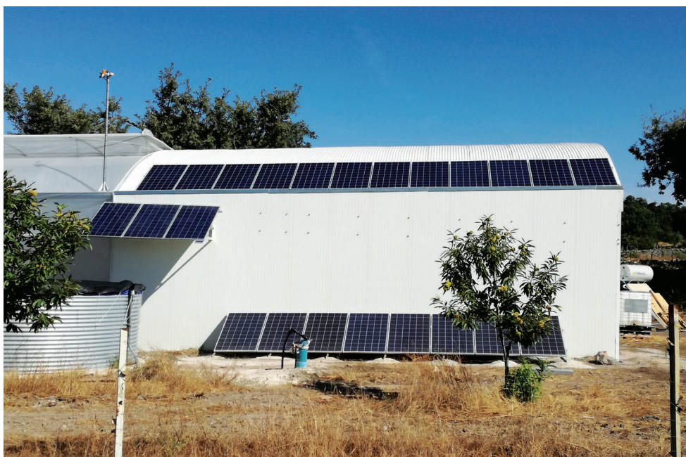
Figura 1 – estufa com sistema fotovoltaico
